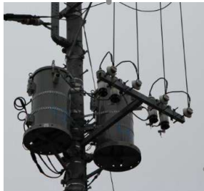
高岳製作所30KVA柱上トランス
